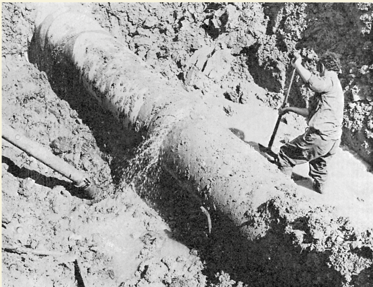
Il sisma ha gravemente danneggiato numerosi chilometri di tubazioni di acquedotto e di condotte fognali. Nella foto, i primi interventi sulla condotta principale dell'acquedotto a ovest di Buia, che fornisce l'acqua al Friuli centrale.
